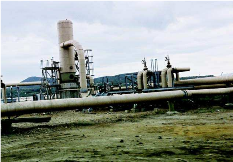
Dicke Rohrleitungen leiten den Dampf aus der Erde zum Kraftwerk
