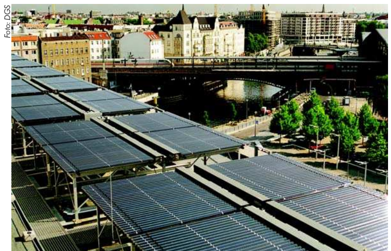
Solaranlage auf dem Dach des Bundespresseamtes in Berlin
