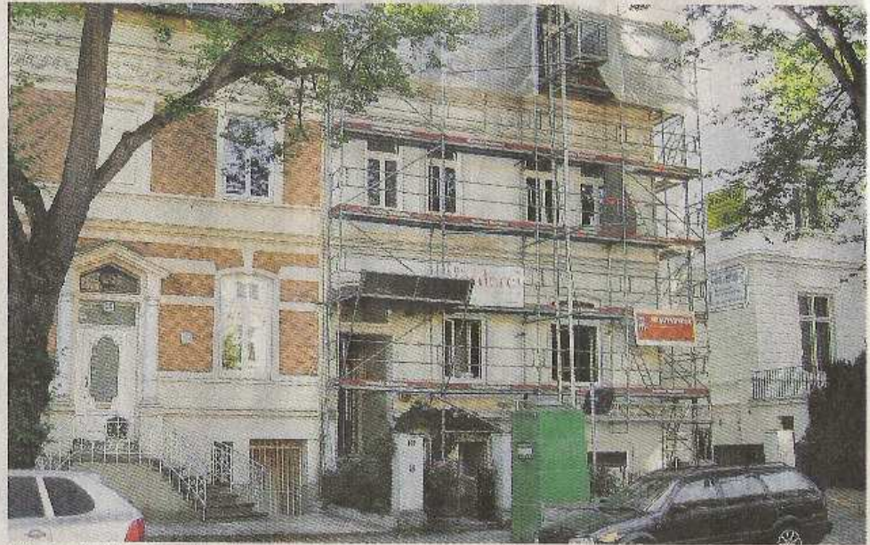
Altbauten sind begehrt – aber die Sanierung reißt oft Löcher in das Budget der Eigentümer. Das Wärmegesetz im Land kollidiert mit den Regelungen auf Bundesebene, was die Besitzer alter Immobilien um Fördergelder bringt. Foto: dpa
