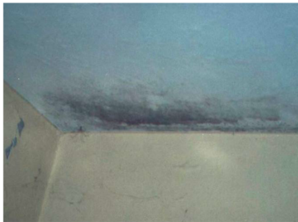
Solche Schimmelecken sind nicht nur unschön, sie sind auch gesundheitsschädlich. Die Sporen der Pilze können Allergien und Atemwegserkrankungen auslösen.
