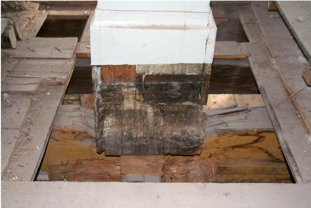
Abbildung 9: Durchgedrückter Deckenbalken unter einer Eichenstütze 176
